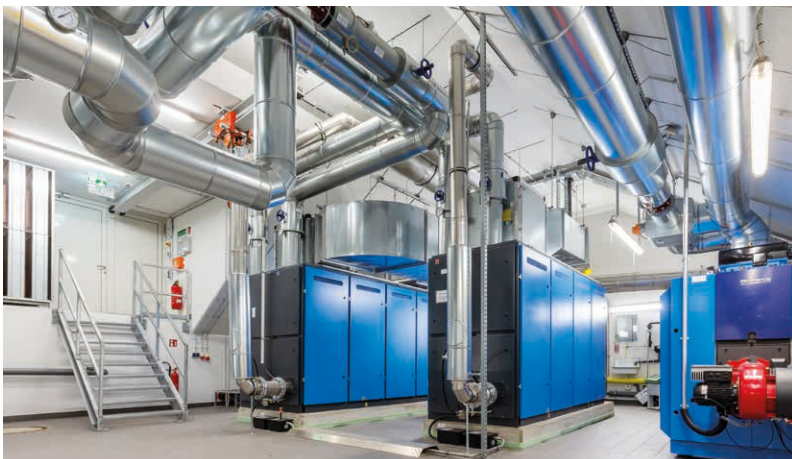
Ein zentraler Baustein der Wärmewende ist der Ausbau des Fernwärmenetzes basierend auf unvermeidbarer Abwärme und Erneuerbaren Energien.
